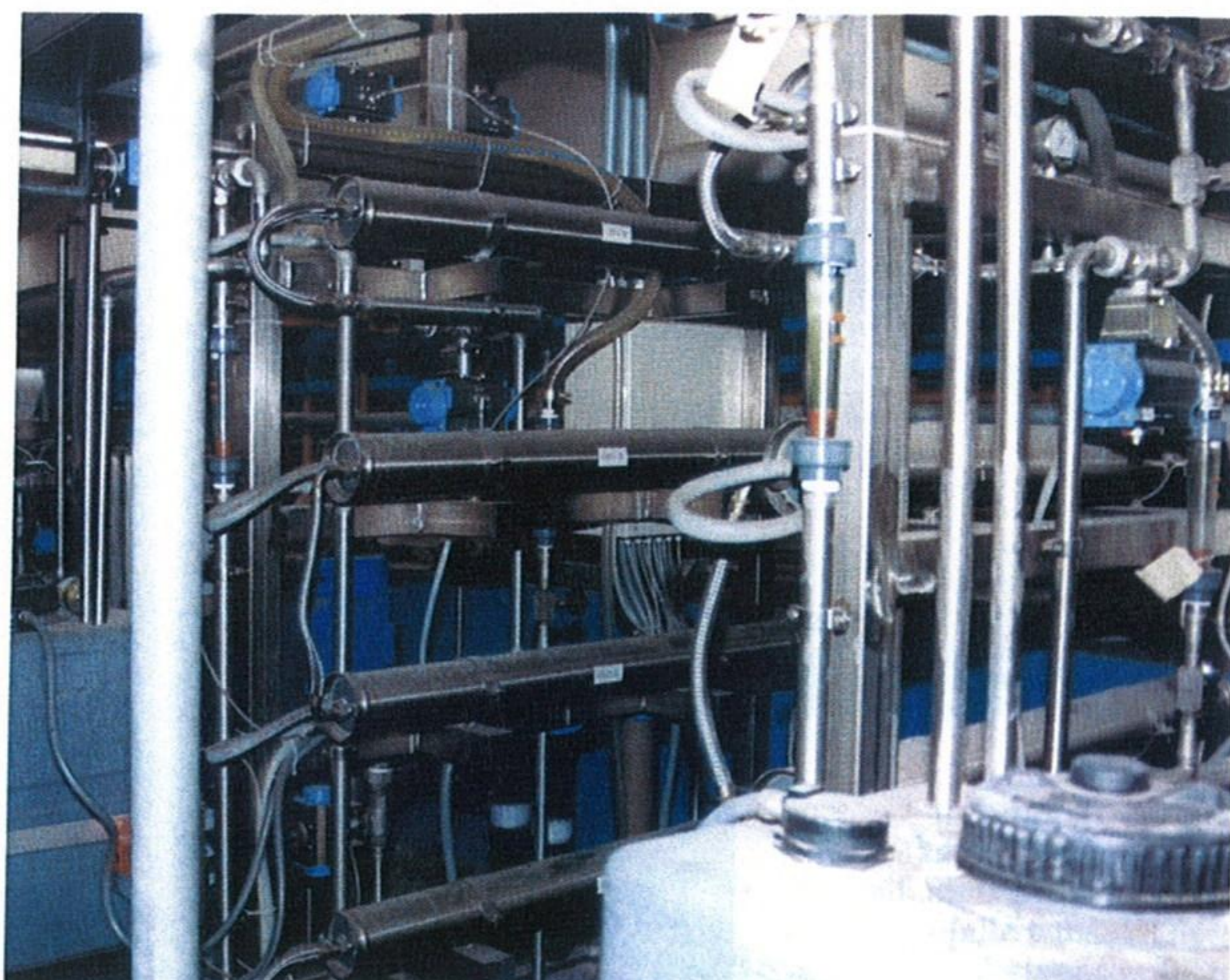
Fig. 17 - L'unità di osmosi inversa: a sinistra, particolare dei filtri della modesta concentrazione dei fanghi di risulta
