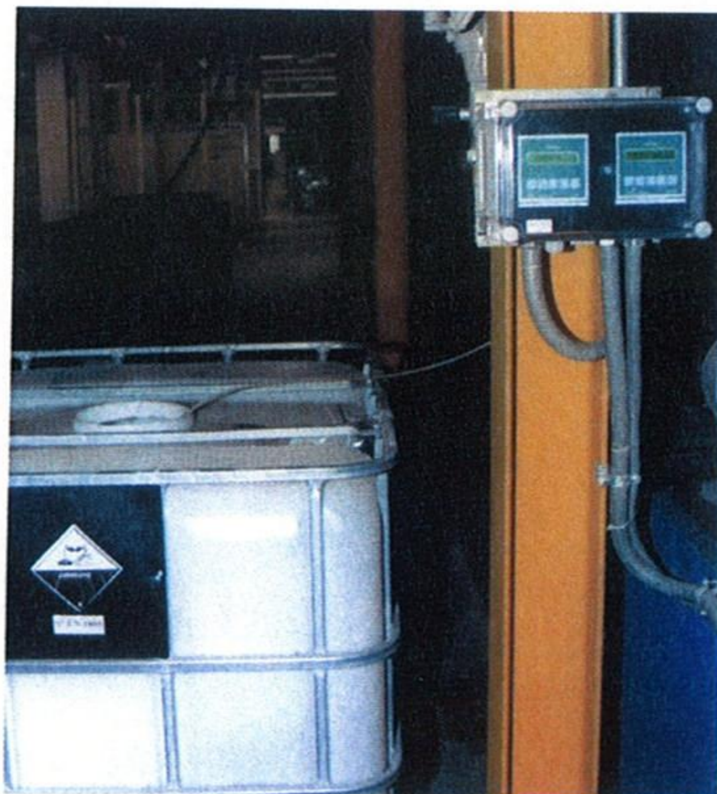
Fig. 14 - L'apparecchiatura elettronica per il dosaggio automatico del fosfosgrassante concentrato
